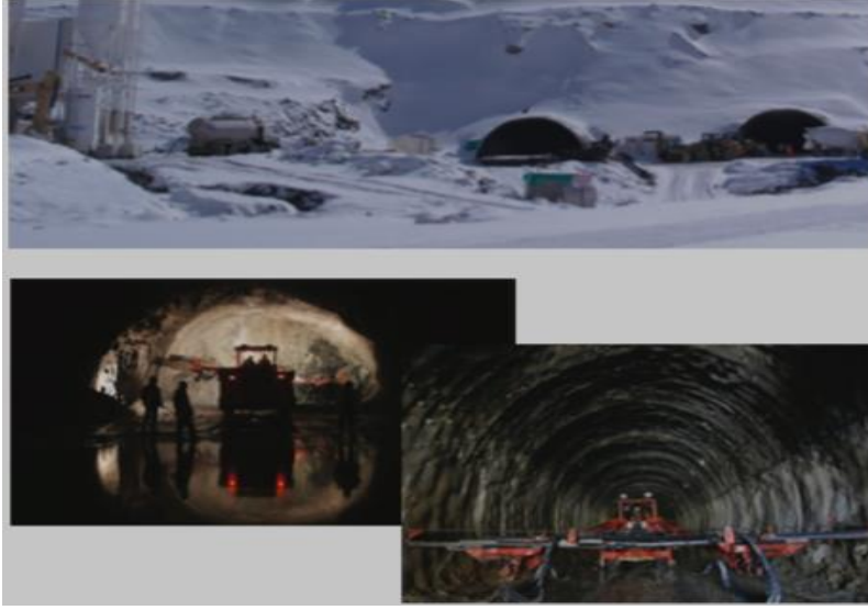
Şekil 4. Ovit Tüneli, Rize (İkizdere)-Erzurum (İspir) Arası Kaynak: Ulaştırma, Denizcilik ve Haberleşme Bakanlığı
